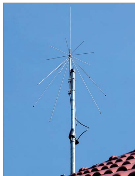
Bild 2: D-130N auf dem Dach eines Wohnhauses; neben der notwendigen Erdung des Mastes ist zu beachten, dass das „heiße“ Ende der Antenne, d. h. die oberen waagerechten Stäbe und der 6-m-Strahler, keine galvanische Erdverbindung besitzt!
